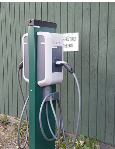
Ladere ved varmecentralen i Munksøgård har to ladepunkter for at udnytte kapaciteten bedst muligt.
